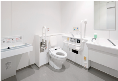
トイレ だれでもトイレ、障がい者用トイレ、オストメイト対応トイレを設置しています。可動間仕切りで、男女のトイレ数を調整することもできます。
